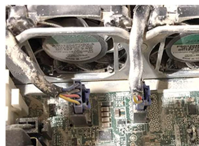
Verschmutzung in Lüftern
